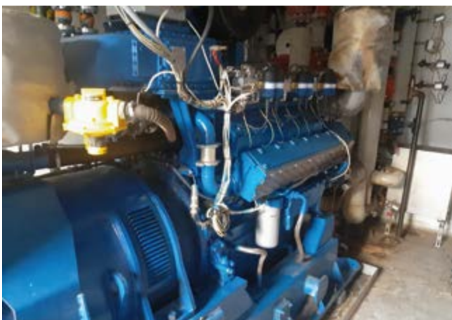
Serce biogazowni – system kogeneracyjny (CHP) biogazowni Bollewick (Niemcy) – produkcja ciepła i prądu w rezultacie spalania biogazu.
