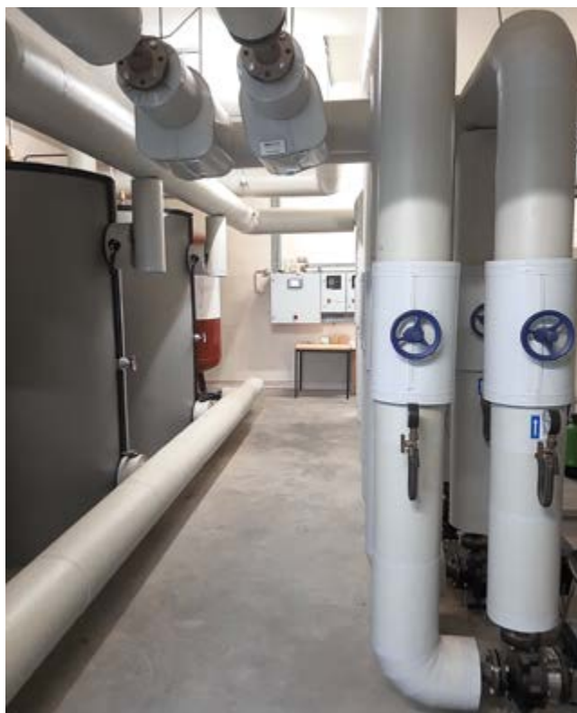
Infrastruktura sieci ciepłowniczej rozprawdzającej energię ciepłą dla mieszkańców gminy Bollewick (Niemcy). Ciepło pozyskiwane ze spalania biogazu.
